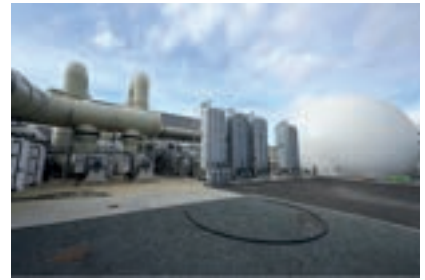
Fig. 2 Espace de filtration des biogaz.
